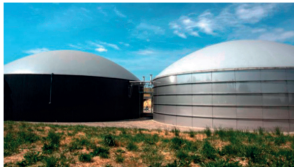
Installation de biogaz Bio-Energ'Etique SA à Bure
