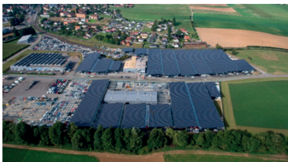
Installation photovoltaïque GEFCO à Courgenay
