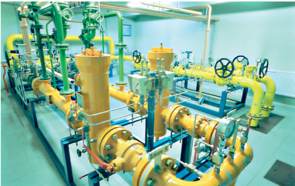
Station de décompression et de comptage à Delémont
