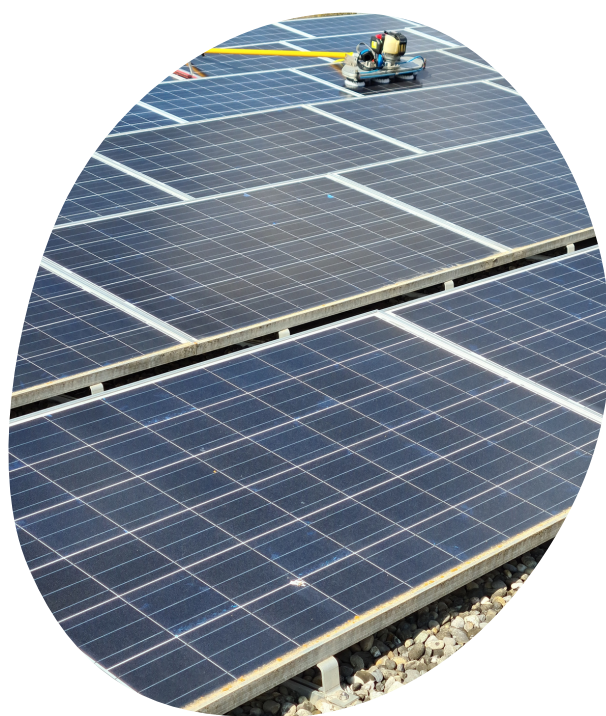
Nettoyage des panneaux de la centrale photovoltaïque d'EDJ de Delémont, mars 2021
