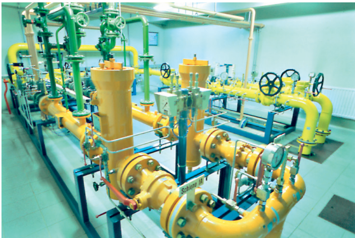
Station de décompression et de comptage à Delémont
